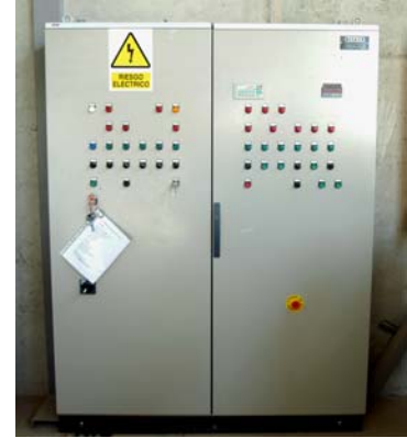
Cuadro eléctrico de control
