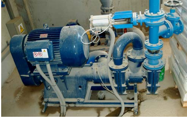
Bomba de alimentación al filtro
