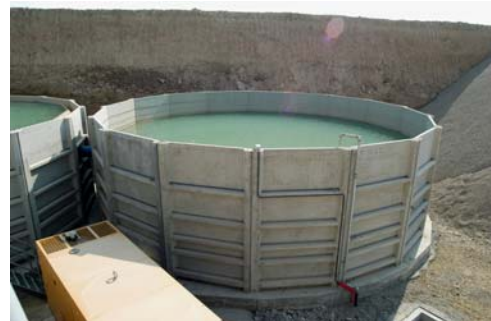
Depósito pulmón de las aguas clarificadas
