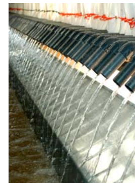
Agua recuperada en el filtro
